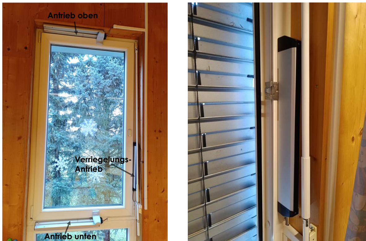
Abbildung 28: Stellantriebe am Fenster, sowie Verriegelungsantrieb (rechts)
