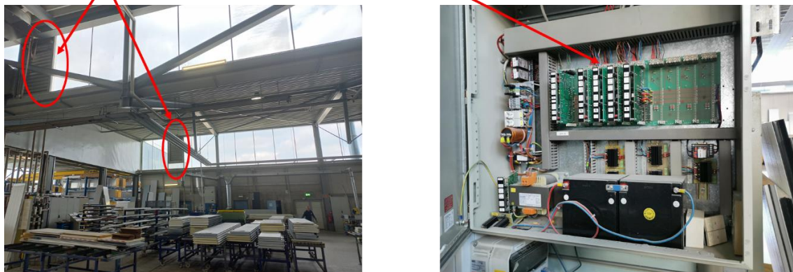
Abbildung 6: RWA-Klappen und RWA-Zentrale
