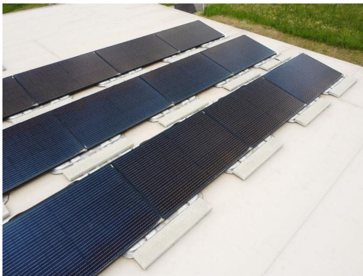
Abbildung 17: 5 kWp PV-Anlage wurde für das EFH Doczekal 2021 errichtet
