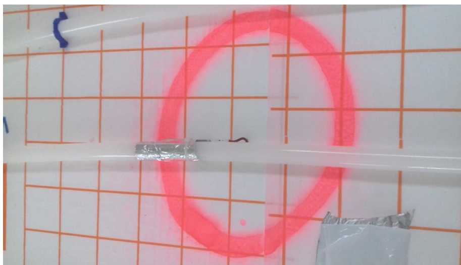
Abbildung 25: Temperatursensor am Rohr der Fußbodenheizung montiert
