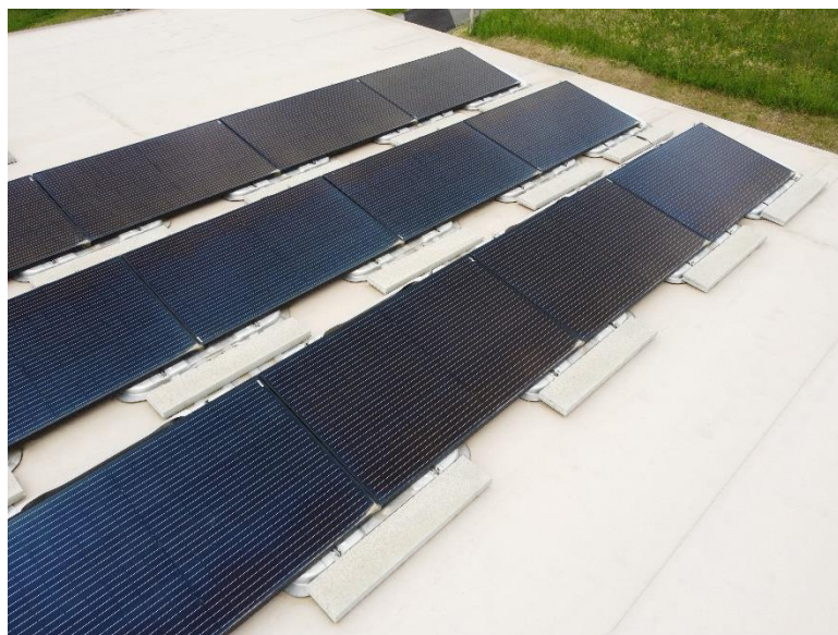
Abbildung 20: 5 kWp PV-Anlage am EFH Doczekal
