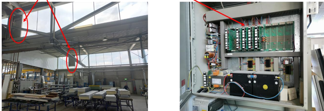
Abbildung 25 Rauchgasklappen und RWA-Zentrale
