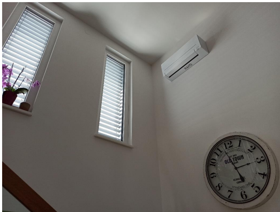
Abbildung 21: Klimaspplitgerät im EFH Doczekal zur zentralen Kühlung des Wohnbereichs
