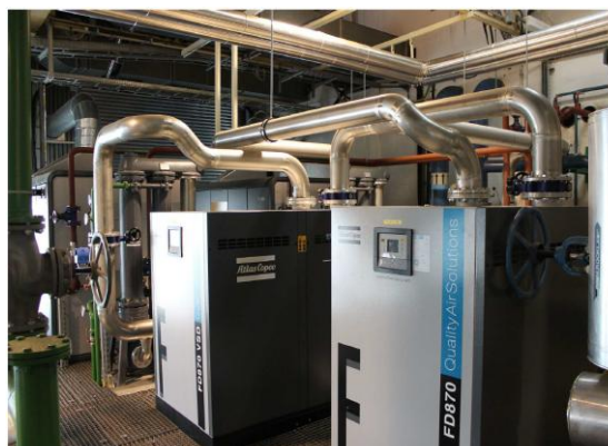
Beispiel Wärmerückgewinnung einer Druckluftanlage
