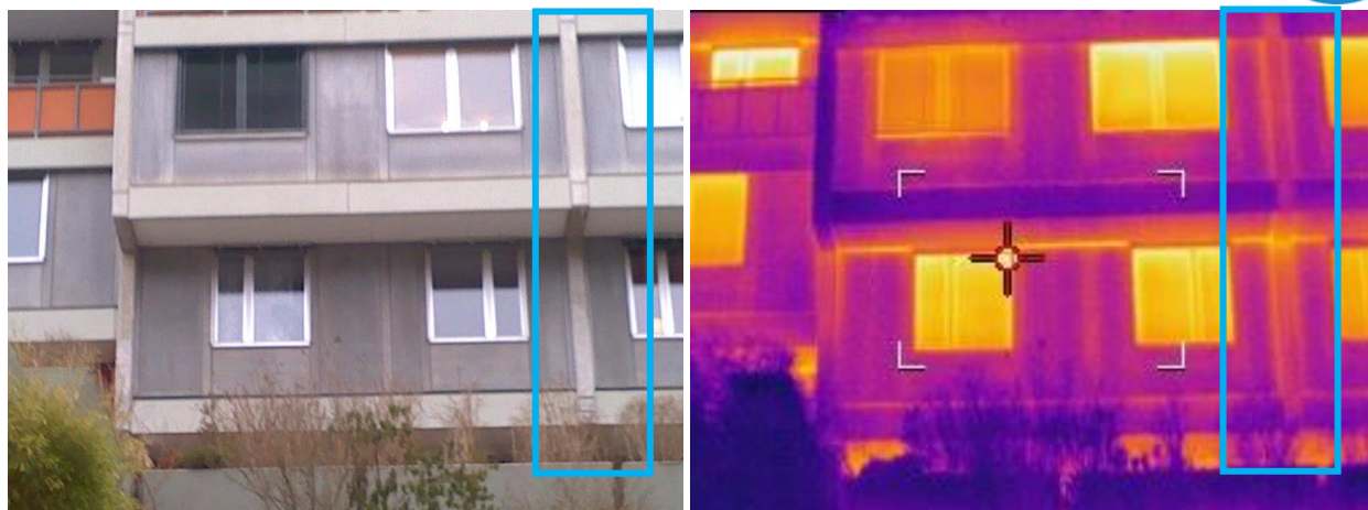
Abbildung 15: Thermografische Aufnahmen einer Wärmebrücke bedingt durch massive Wandscheiben.
