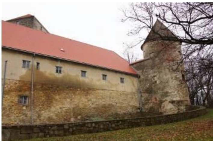
Abb. 64: Foto Vorwerk – Veranschaulichung des variierenden Zustands des Mauerwerks 112
