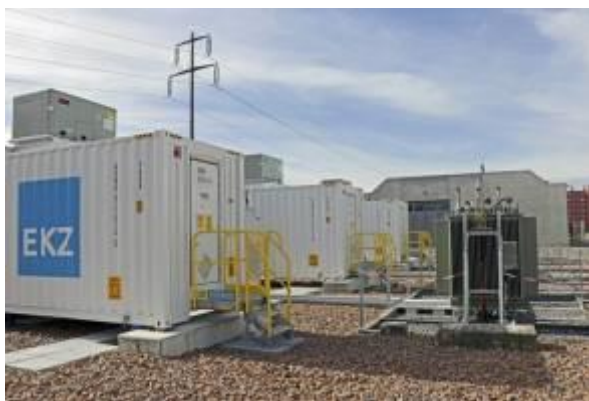
Abb. 19: größter Batteriespeicher der Schweiz in Volketswil 44
