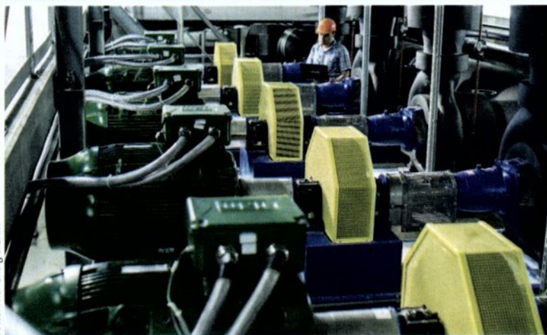
Fotos: Wien Energie/EHM
