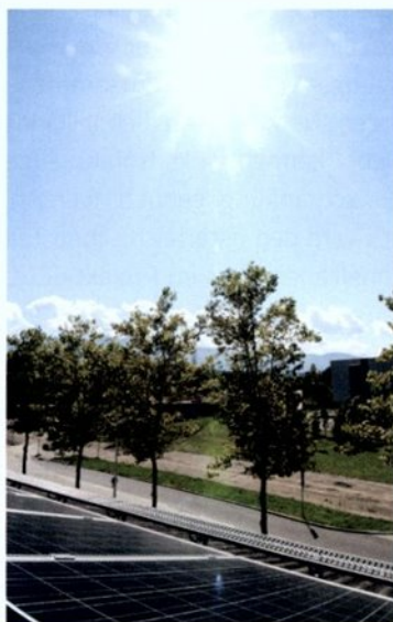
Photovoltaikanlage im Demogebiet für neue Technologien in Villach FOTO: ADRIAN HIPPE
